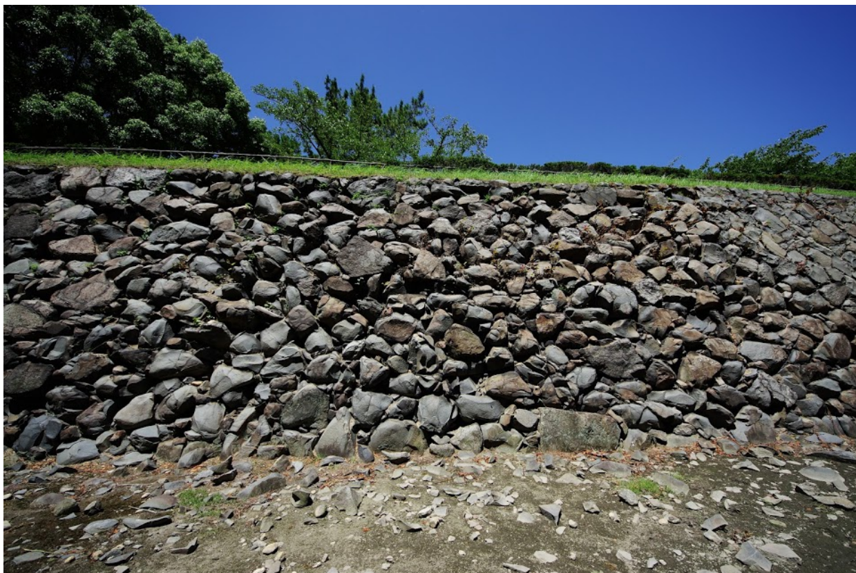
図2 熱を受けて剥落したり破断したりした大天守空堀外側の石垣（上部は見学通路）
